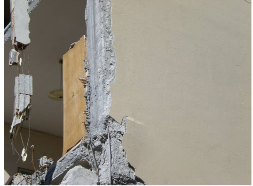
Carenza ancoraggio solai
