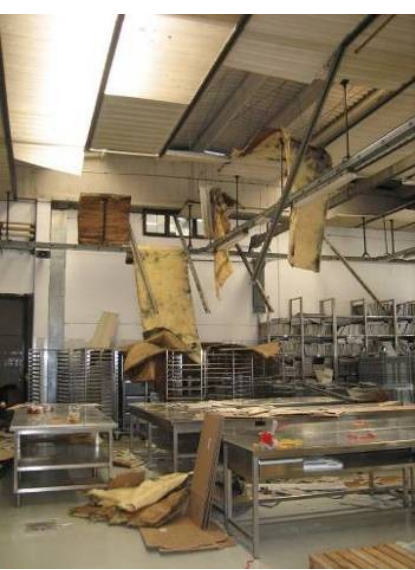
Edificio Industriale, loc. Bazzano (2009, L'Aquila Earthquake)
