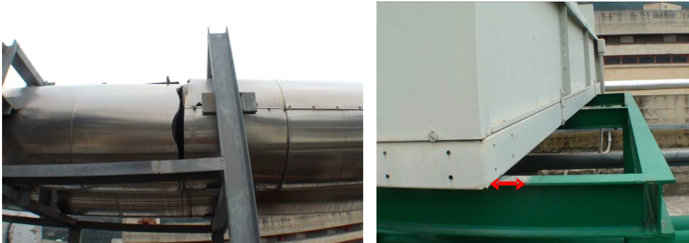
Fig. 1. Dommages aux installations, Hôpital de L'Aquila (2009).
